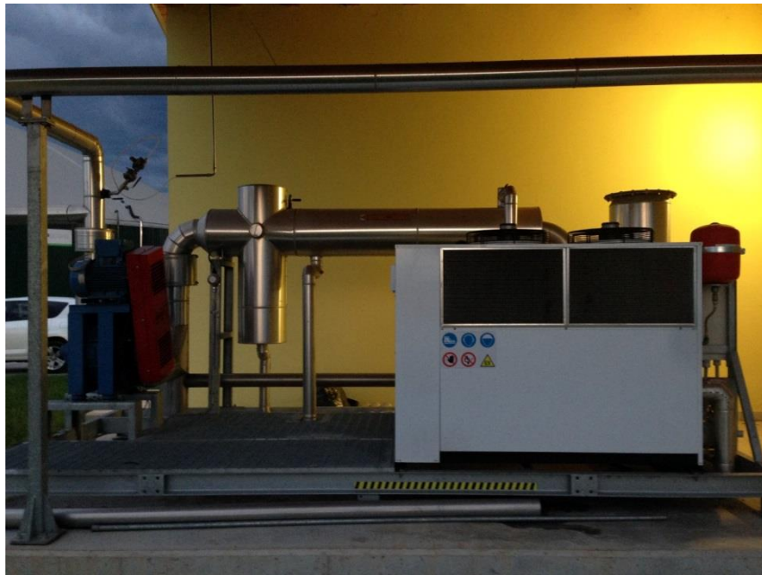
Sorgente sonora analizzata : Chiller di raffreddamento
