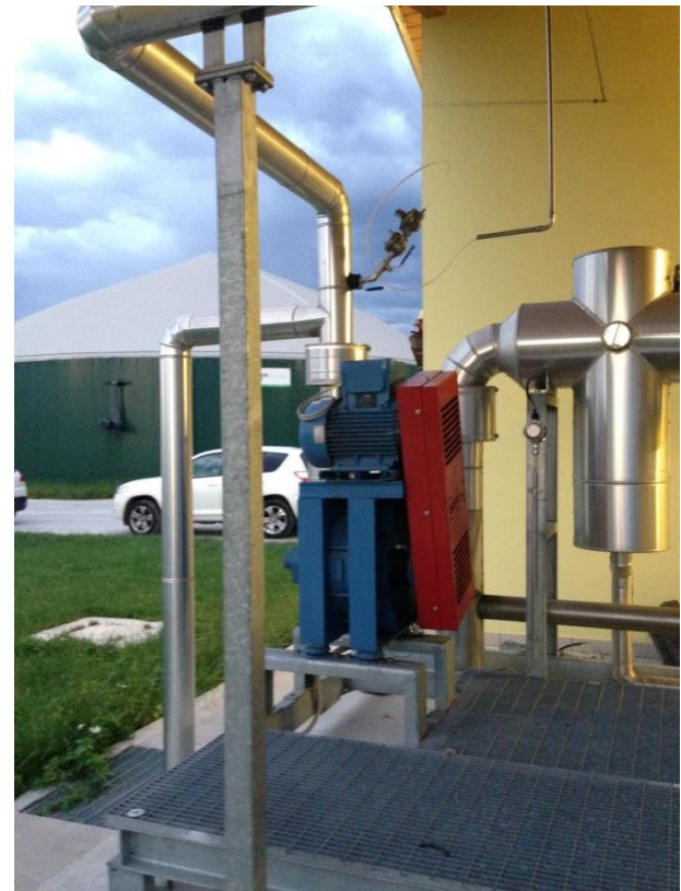
Sorgente sonora analizzata : pompa
